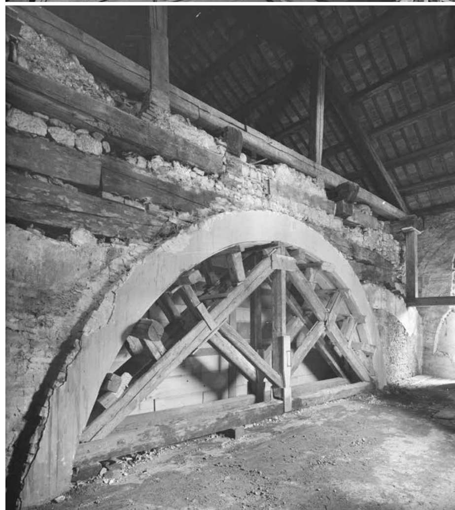
8. Braccio sinistro del transetto, 1934. La cassaforma per la gettata della nuova trave del transetto in cemento armato.
