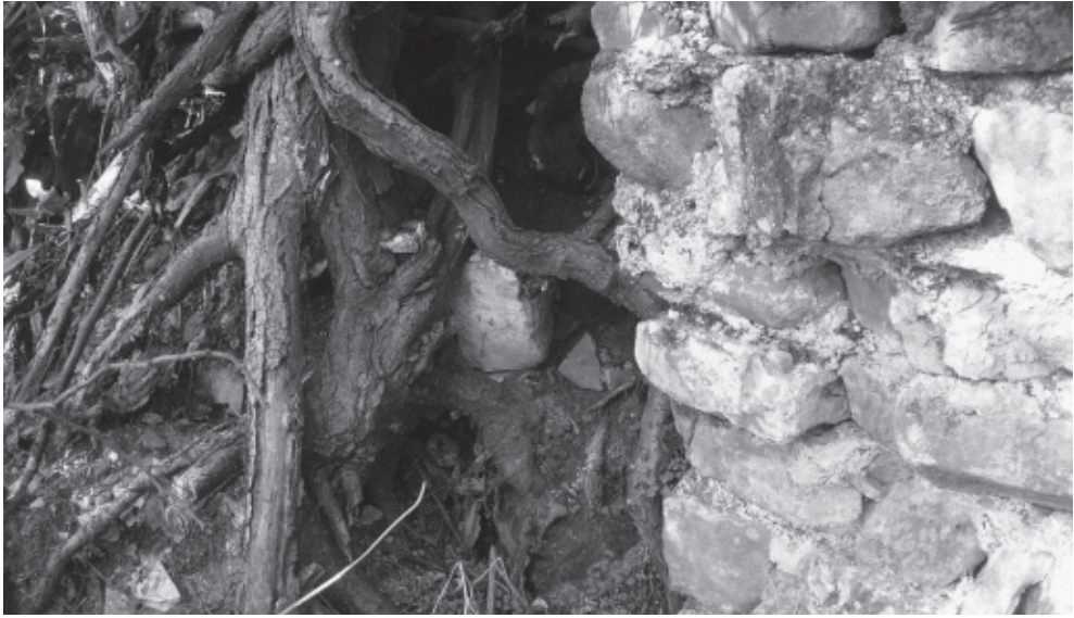
Fig. 5 – Esempio di aggressione degli apparati radicali su un tratto di muro del settore sud dell'insediamento.
